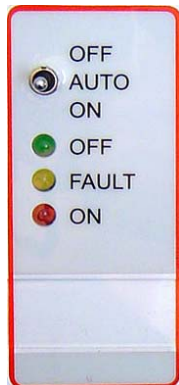
Fan Control Unit
